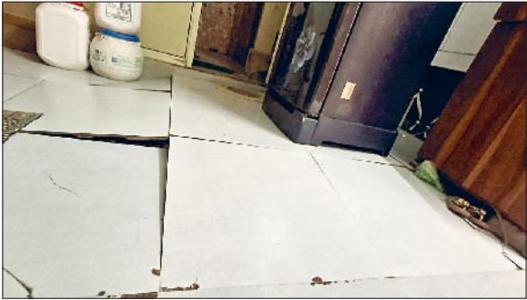
झज्जर। साथ लगते घरों की धंसी फर्श व मंडी मोहल्ला के खाली पड़े बदहाल मकान में बना गड्ढा।
